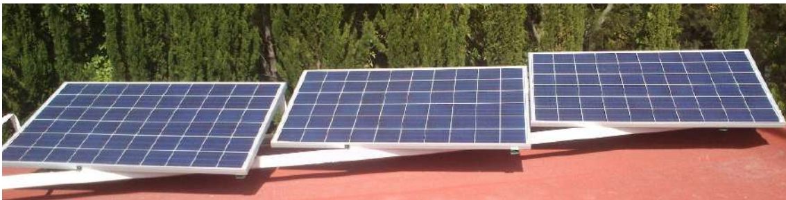
Figura 6.21: Paneles solares fotovoltaicos instalados.
