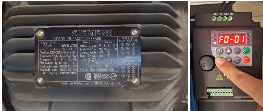
Figura 81. Placa de características del motor y panel de control de VDF.
